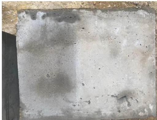
ภาพ 2.5.2 คอนกรีตบล็อกหลังการชำรุด โดยด้านที่สีเข้มกว่า คือ ด้านที่ทำการชำรุด
